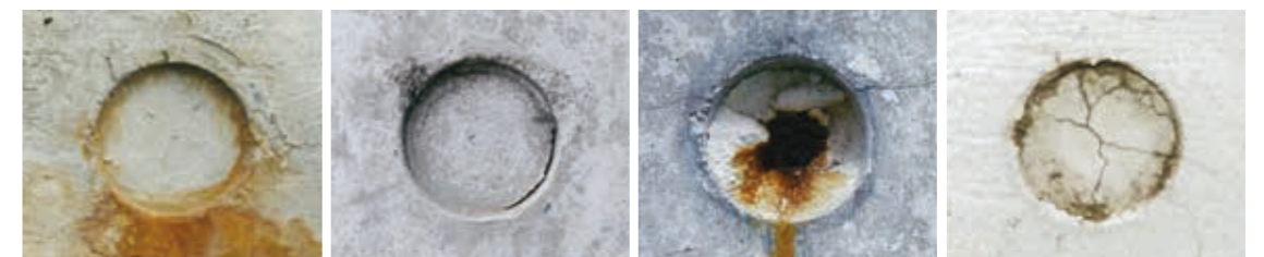
●サビのしみ出し ●すき間 ●爆裂 ●ひび割れ
